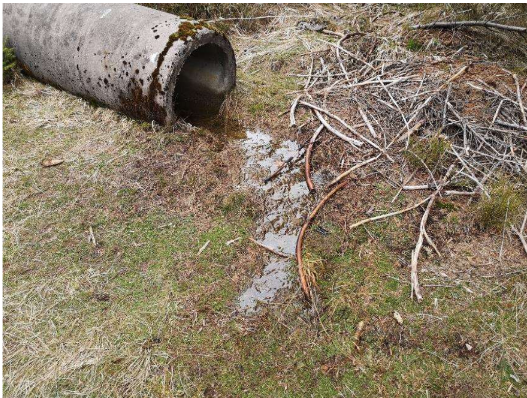
Obr. 4.1.2 - Výtok z propustku pod lesní cestou, potok se zde téměř okamžitě vsakuje do půdy
