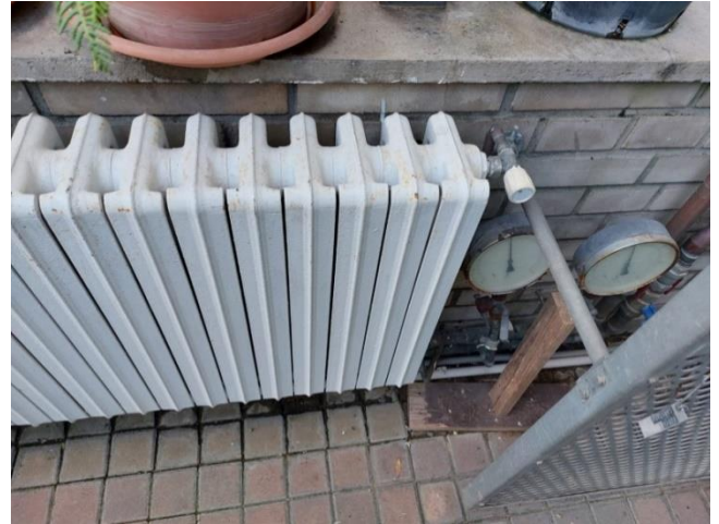
Obrázek 6 - článkové otopné těleso ve skleníku č. 7 – úroveň u podlahy. Je možno vidět připojení měděného rozvodného potrubí na litinové otopné těleso a tlakoměr na přívodním a vratném rozvodném potrubí.
