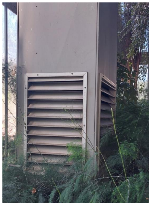
Obrázek 29 - nasávací potrubí vedoucí ke vzduchotechnické jednotce
