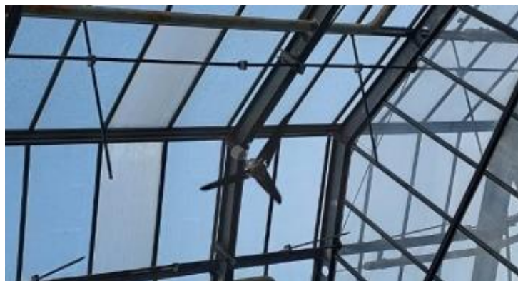
Obrázek 11 - axiální ventilátor umístěný u roviny zasklení ve skleníku 7
