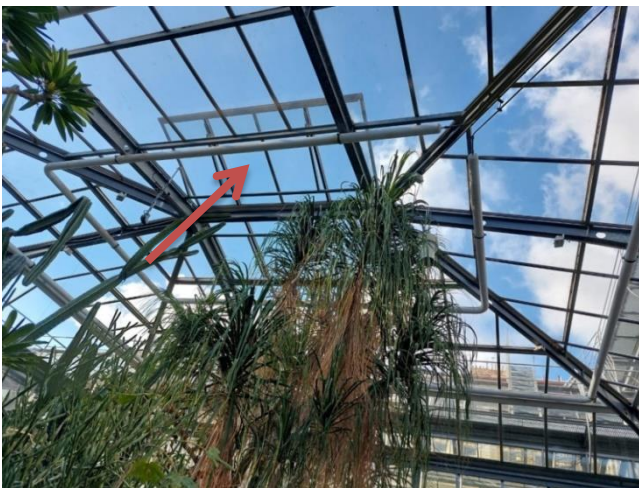
Obrázek 7 - otopné registry v úrovni zastřešení ve skleníku číslo 13 – označeno šipkou
