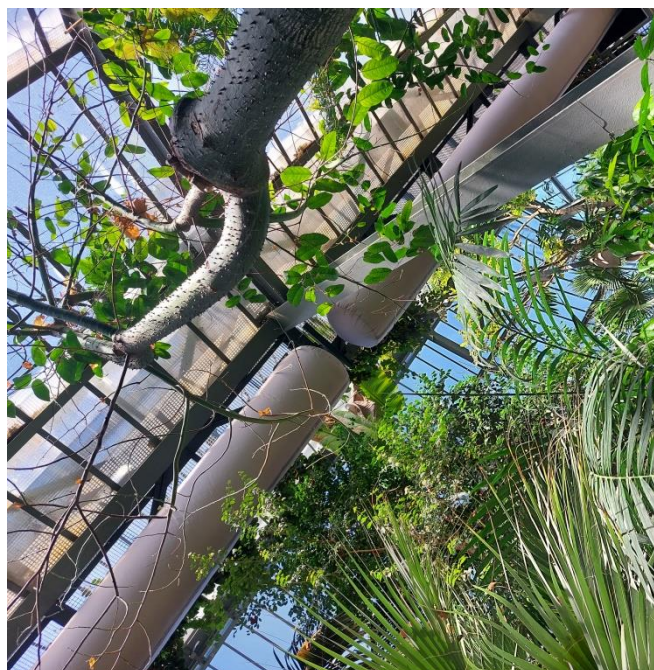
Obrázek 30 - nasávací potrubí vedoucí ke vzduchotechnické jednotce
