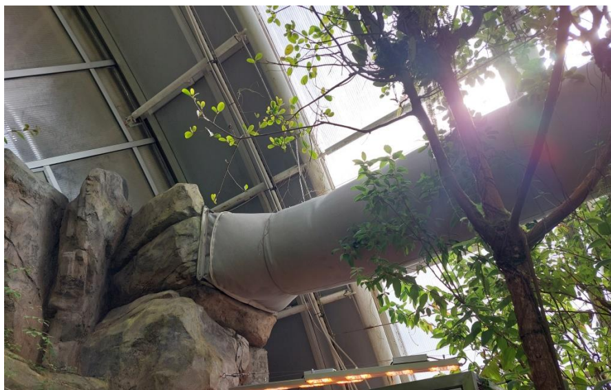
Obrázek 22 – textilní vzduchotechnické potrubí ve skleníku horského lesa
