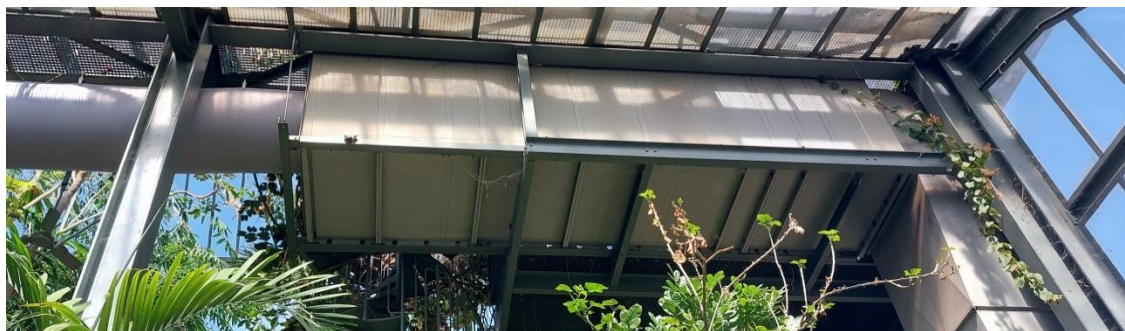
Obrázek 28 - vzduchotechnická jednotka v hlavním skleníku
