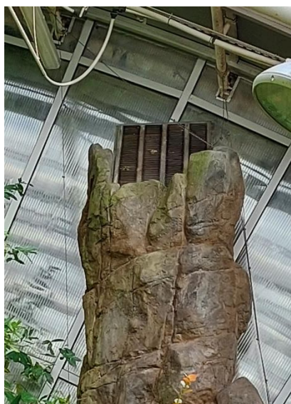
Obrázek 21 – nasávání do vzduchotechnické jednotky ve skleníku horského lesa
