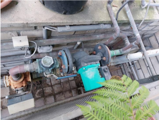
Obrázek 6 - část rozvodu větve pro skleníky 7 a 8. Na obrázku je možno vidět sekundární čerpadlo (uprostřed, modré) pro rozvod otopné vody do otopných těles v rovinách zastřešení objektu. Dále jsou vidět kulové uzávěry a trojcestný ventil za čerpadlem.
