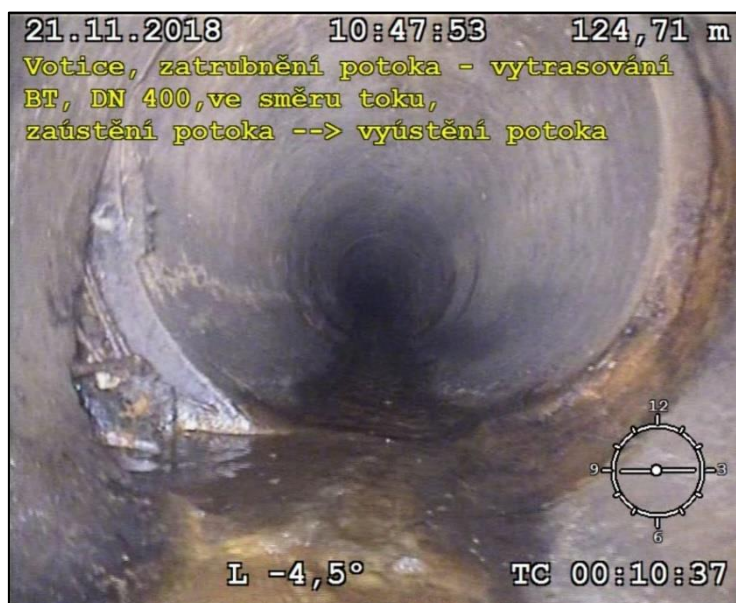
Obrázek 12 - Puklina v potrubí na jeho levé straně (místo ukončení kamer. záznamu) [27]
