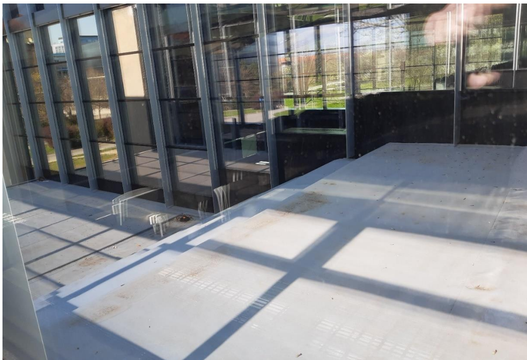
Obrázek 18 Pohled na stávající stav střechy, autor: Ing. Adam Vokurka, Ph.D.
