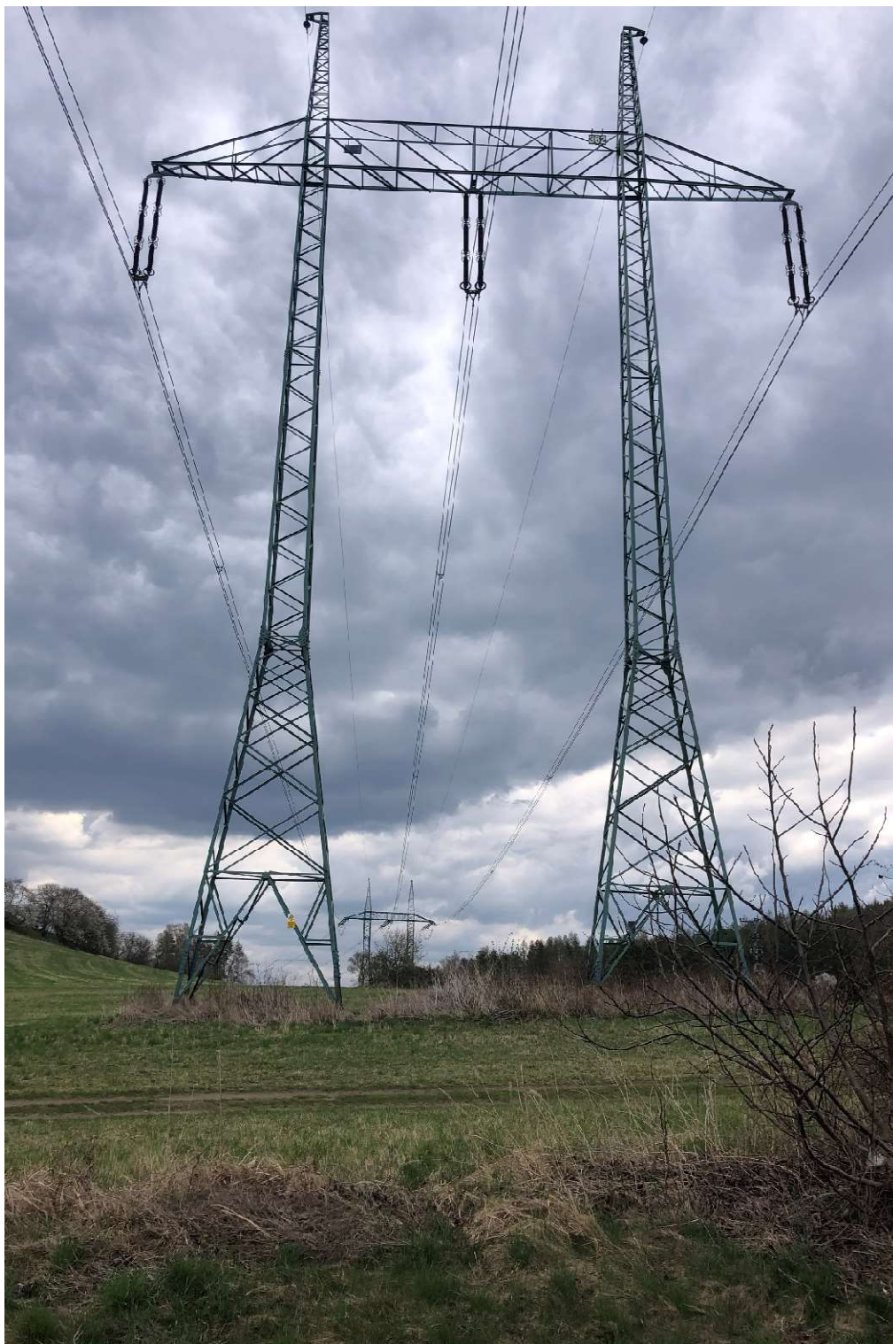
Obr. 7 – Stožár zvláště vysokého napětí
