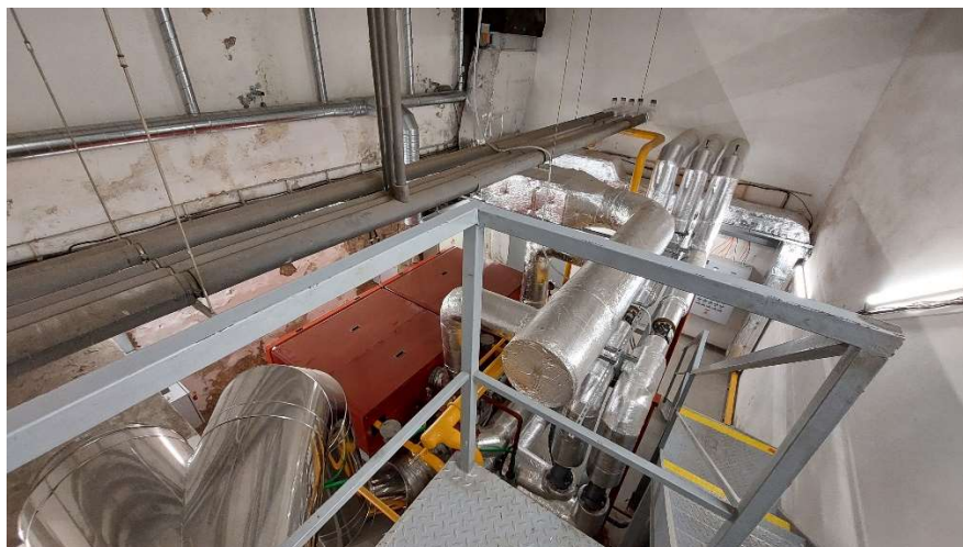
Obrázek 1: Kotelna, místnost 1, Masarykova kolej
