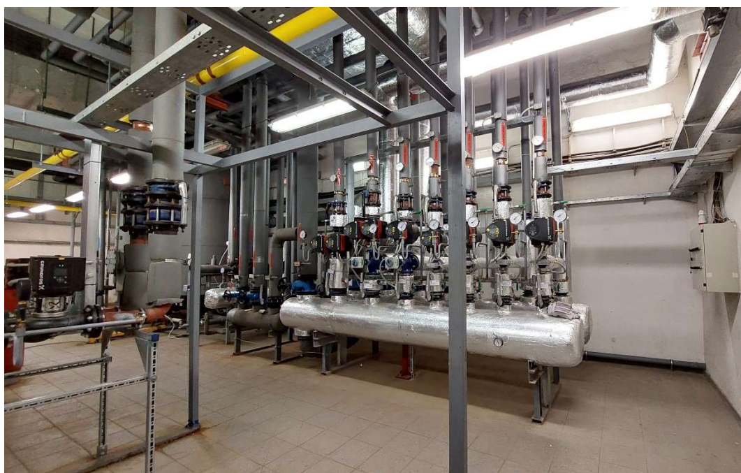
Obrázek 2: Kotelna, místnost 2, hlavní rozdělovač a sběrač
