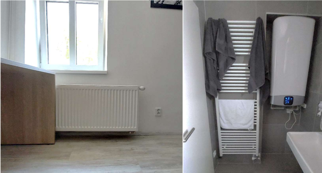
Obrázek 29: Příklad otopných těles v řešeném objektu, deskové otopné těleso (vlevo) a trubkové otopné těleso a zásobník TV (vpravo)
