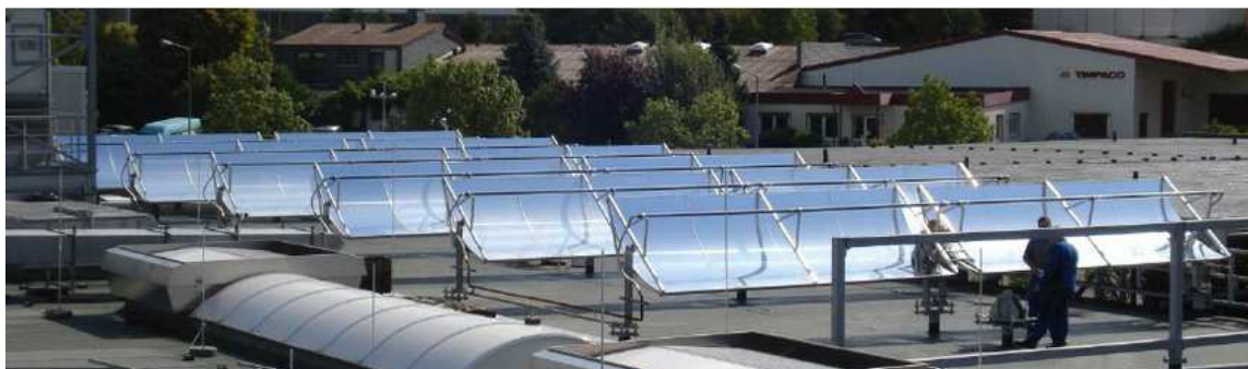
Obrázek 28 Parabolický koncentrační kolektor na střeše objektu
