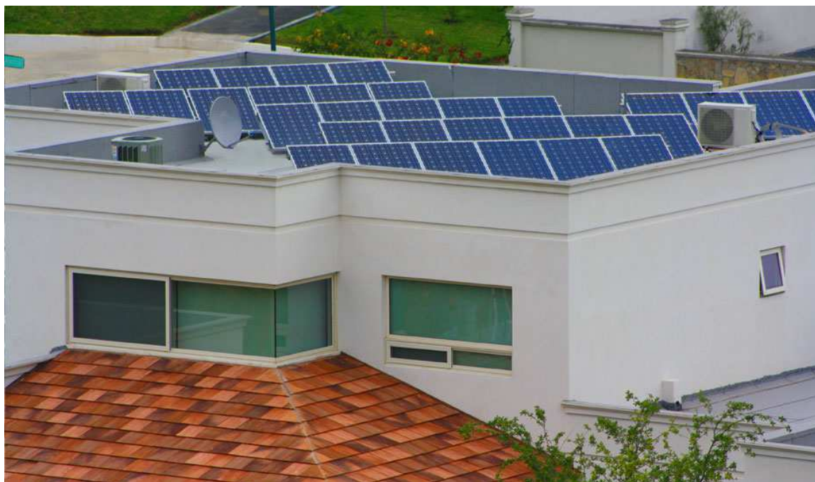
Obrázek 1 Negativní příklad použití fotovoltaických panelů; zdroj: http://www.bjxenergia.com/
