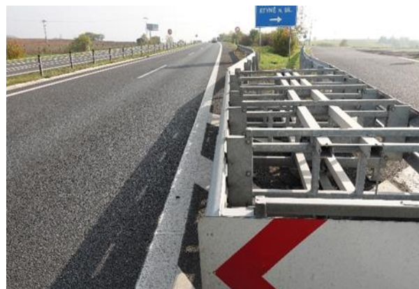
Obrázek 60 – Tlumič nárazu nacházející se v dopravním stínu. (MÚK Malhostice I/63 SMV x III/253 36)
