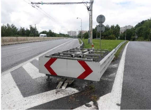
Obrázek 61 – Neopodstatněně umístěná svodidla na pravé straně tlumiče nárazu. (MÚK I/7 x III/252 4)
