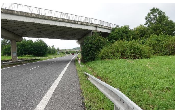
Obrázek 46 – Absence propojení nově osazených a stávajících svodidel.
