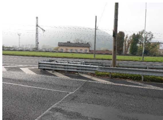
Obrázek 66 – Poloha tlumiče nárazu před sloupem trakčního vedení. (MÚK I/62 x MK Podmokelská)
