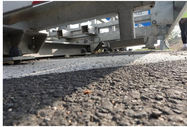
Obrázek 56 – Mezera mezi vozovkou a tlumičem nárazu.
