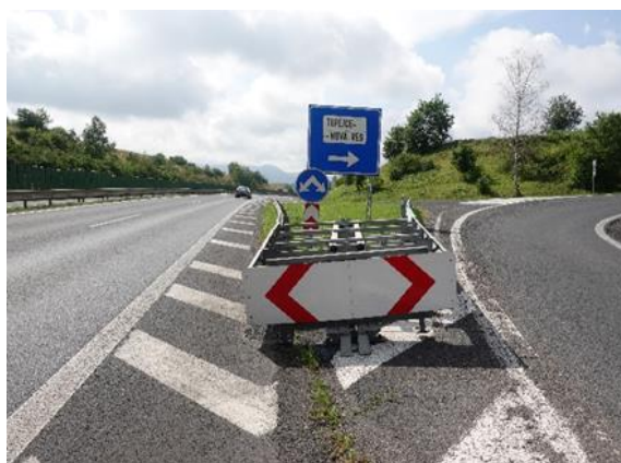
Obrázek 72 – Neopodstatněné umístění tlumiče nárazu do dopravního ostrůvku. (MÚK I/13 x III/253 28)
