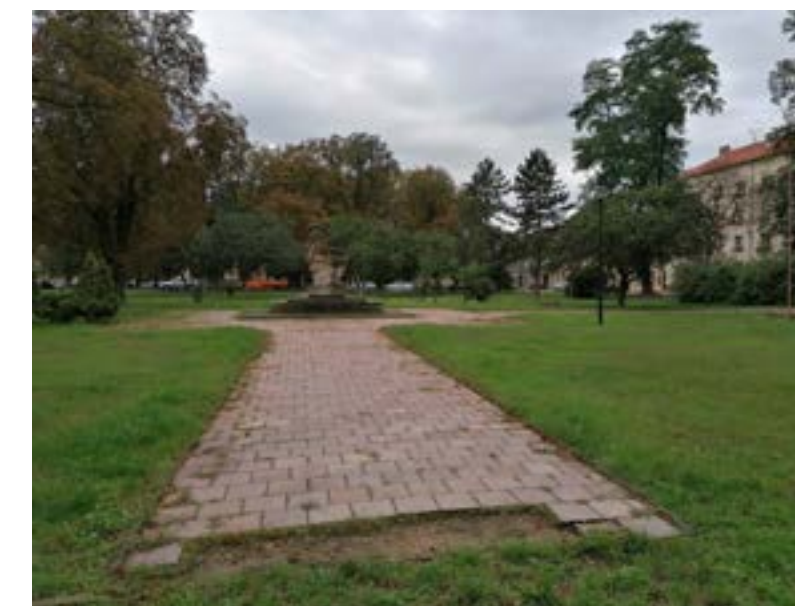
pomník Osvobození _dlažba ve špatném technickém stavu
