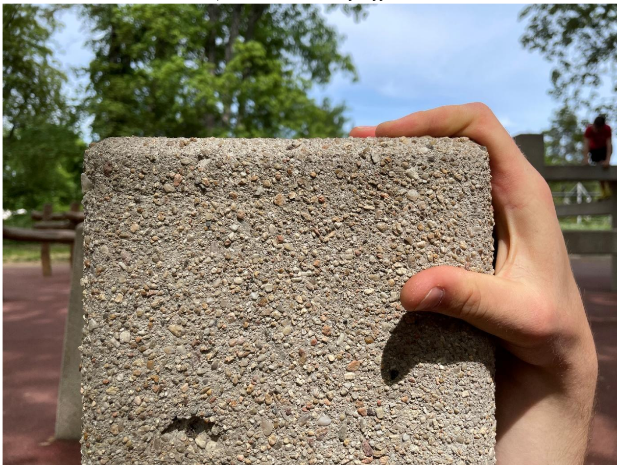
Obr. 63: Detailní zobrazení vymytí betou a zkosené hrany.
