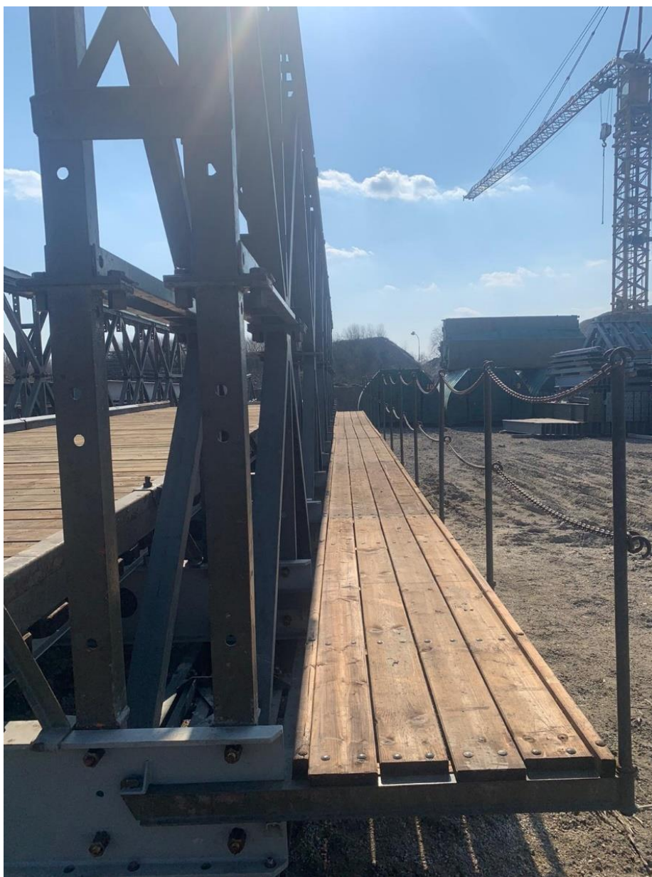
Obrázek 19 – Mostní souprava TMS včetně chodníku
