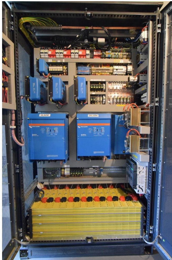
Obrázek 8 Rozvaděč Českého soběstačného domu
