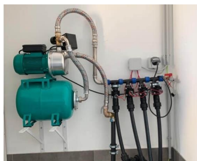
Obrázek 30 Automatika zavlažovacího systému
