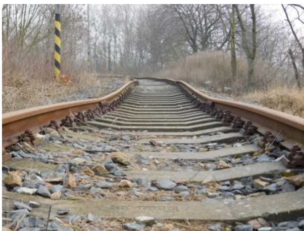
Obrázek 7 - Nerovnosti na trati v blízkosti stanice Teplice, lesní brána (zdroj: autor)
