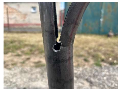
Obr. 89: trhlina v trubce, 3/2022
