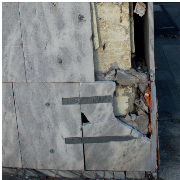
poškodený mramorový obklad - poradie vrstiev - mramor, vzduchová medzera, (papier) a izolácia
