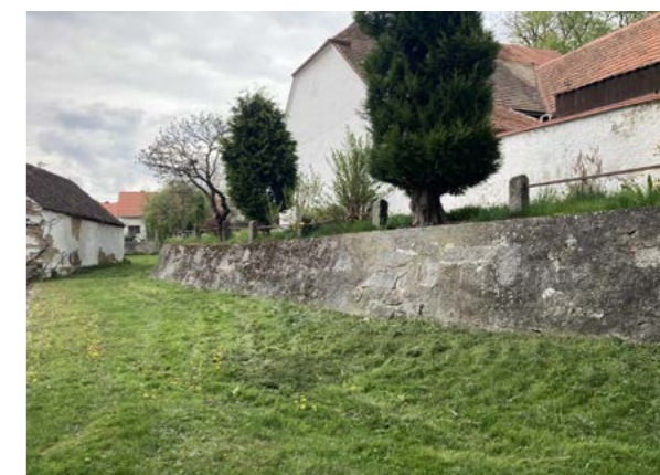
opěrná zeď a nevhodná zeleň
