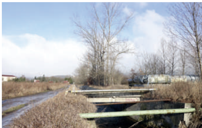
Obr. 23 – Lávka na počátku úseku, do Proboštova vede pěšina podlézající teplovod
