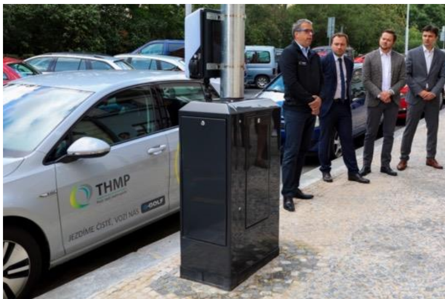
Obrázek 7 – Dobíjecí stanice pro elektromobily AC 22 kW integrovaná do lampy veřejného osvětlení Praha.
