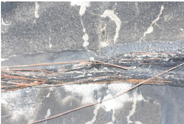
Obrázek 4 Úchytný segment polystyrenového zateplení zasahující do elektroinstalace
