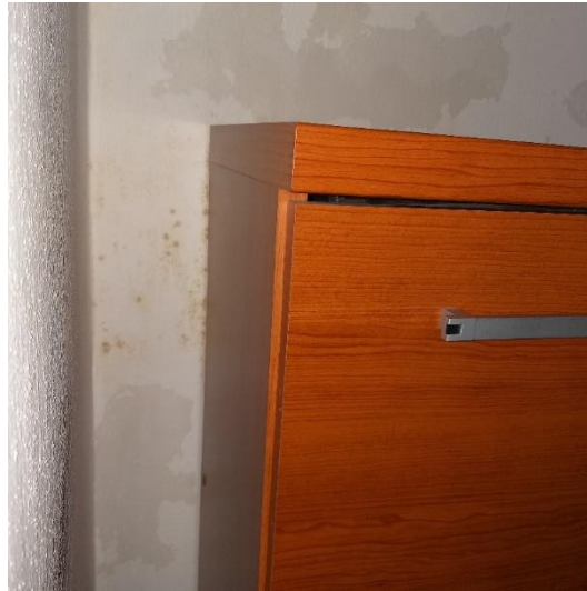
Obr. 11 - Kolizní jev jako výsledek snížení hodnoty hsi vlivem zateplení obvodové stěny v kombinaci s nedostatečnou cirkulací vzduchu a sálání vnitřního povrchu obvodové stěny díky přistavěnému nábytku. Zdroj: fotoarchiv autora
