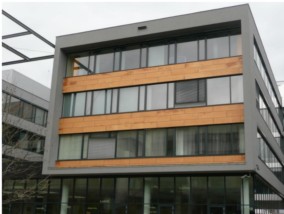
Obr. 3 - Poruchy vnějšího obkladu lamelami vysokotlakého laminátu s viditelnými plochami zvlhnutí některých lamel Zdroj: fotoarchiv autora
