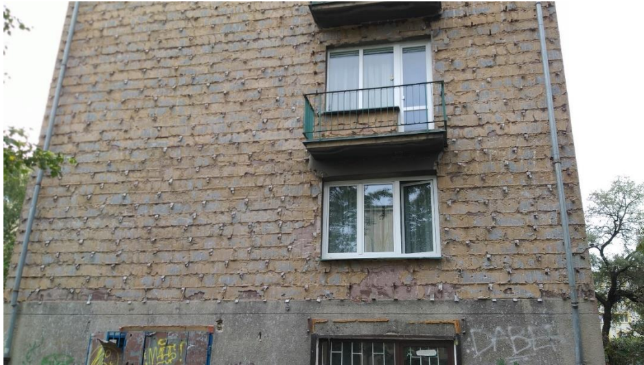
Obr. 9 Zateplení fasády bytového domu Praha 9 - Hloubětín. Stav po sejmutí vnější přízdívky ze škvárobetonových tvárnic.
