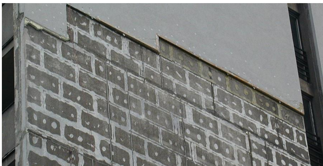
Obr. 12 Kolizní jev ztráty stability ETICS v důsledku sání větru jako výsledek nesprávné aplikace lepení desek tepelné izolace Zdroj: KLÁSEK 2013, Nové možnosti oprav nestabilních ETICS a zdvojování ETICS. https://stavba.tzb-info.cz/zateplovaci-systemy/10444-nove-moznosti-oprav-destabilnich-etics-a-zdvojovani-etics
