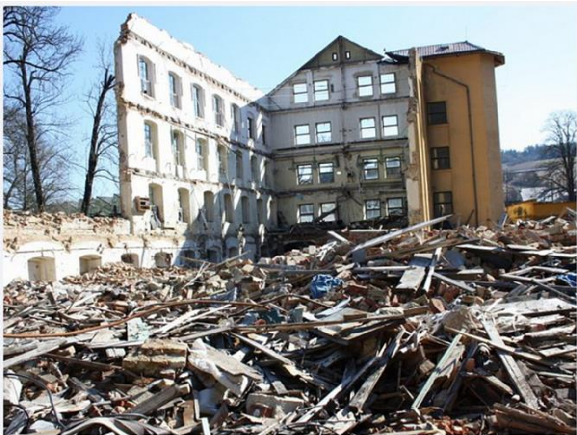
Obr. 11. Stav objektu továrny 25. 4. 2012 [95].
