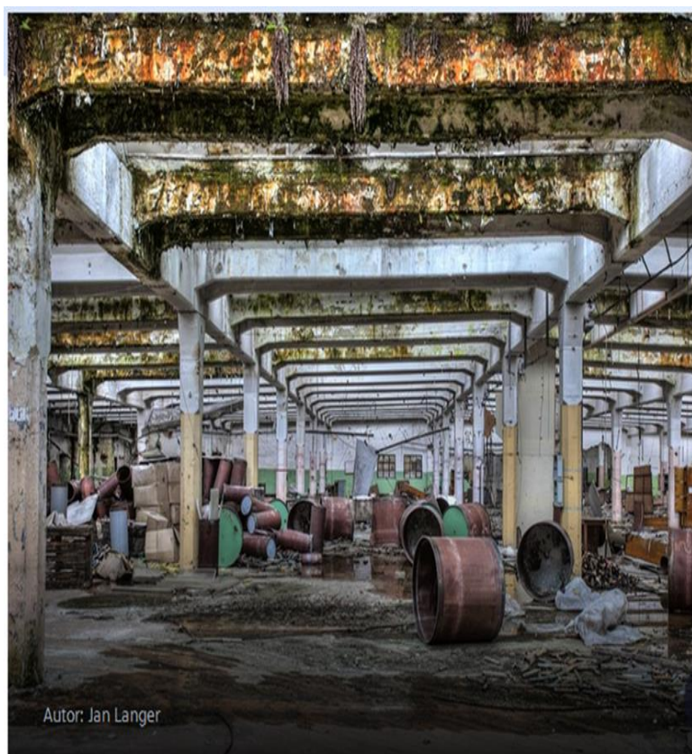
Obr. 18. Bývalá tovární hala zaplněná sudy s nebezpečnými látkami a podlaha kontaminovaná vylitými kapalnými nebezpečnými látkami [102].
