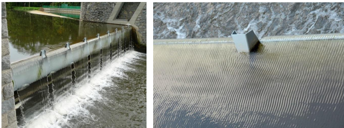
Obr. 10 - Projev samobuzených kmitů ocelové klapky na zvlněné hladině a přepadovém paprsku (Doksany)
