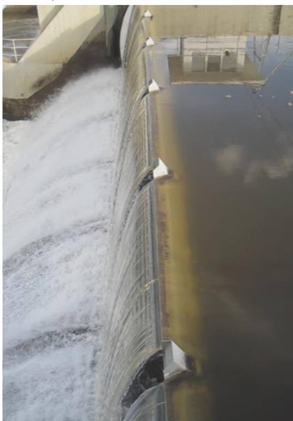
Obr. 11 - Projev samobuzených kmitů ocelové klapky na zvlněné hladině a přepadovém paprsku (České Vrbné)
