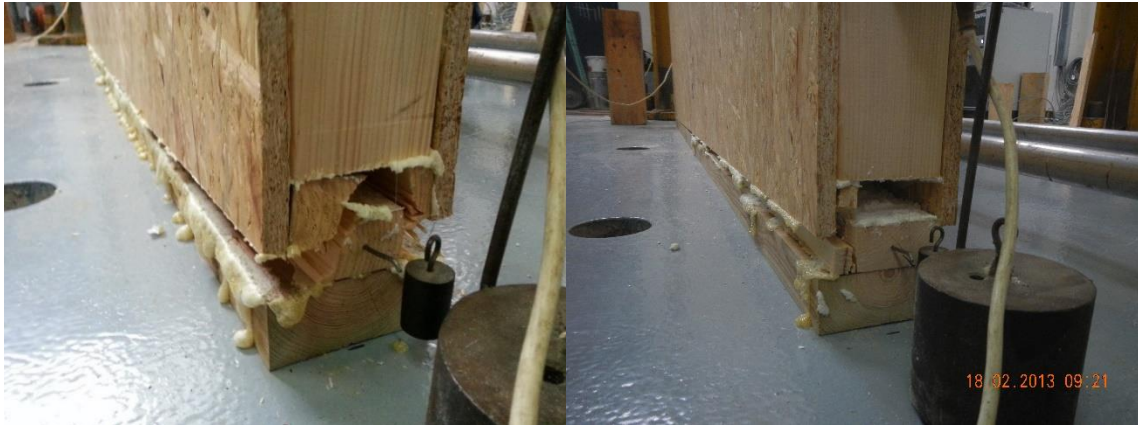
Obr. 33 Porušení spodního lemujícího prvku výztužné stěny
